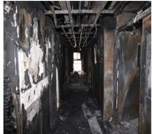
图8 南通道六层墙面过火情况（由东向西）
