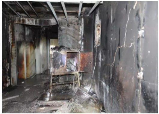
图6 配电箱底部可燃物被烧毁（由西向东）
