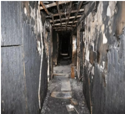
图7 北通道五层墙面过火情况（由东向西）
