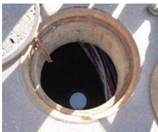
(d) 电力电缆井
